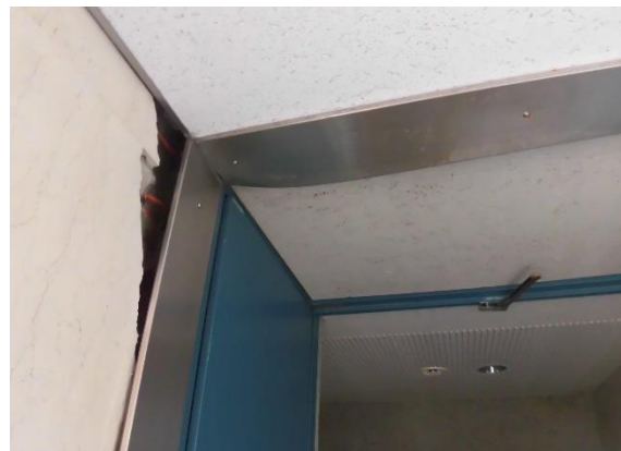
美術館・図書館の連絡通路の壁破損
