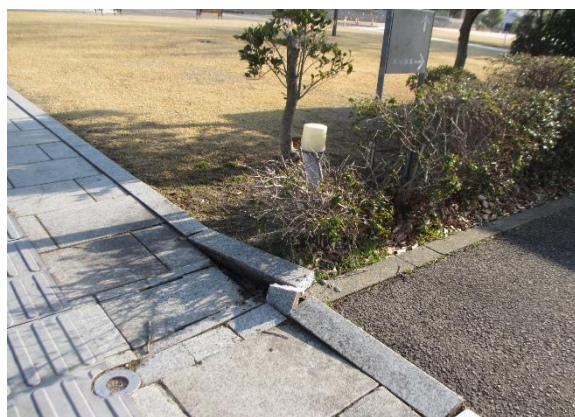
駐車場角 縁石・石畳の破損
