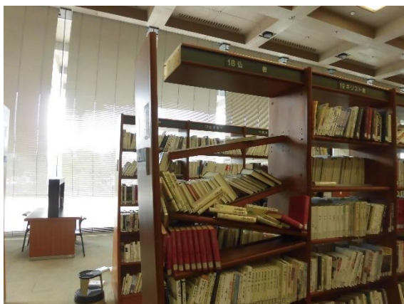
棚の破損・資料の落下
